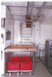
Über die Rohrbahn gelangen die Schlachtkörper in den Produktionsraum und können auf dem Arbeitstisch groberlegt werden.
